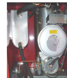
ステンレスボイラー、バーナー部
