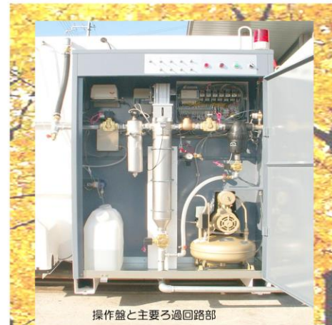
操作盤と主要ろ過回路部
