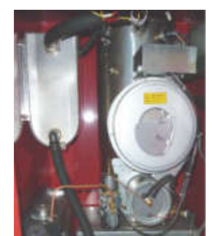
ステンレスボイラー、バーナー部
